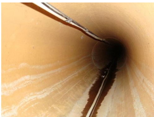
Figuur 4: een kijkje in de rioolbuis van proefopstelling met kabel tegen plafond en op de bodem van het riool
