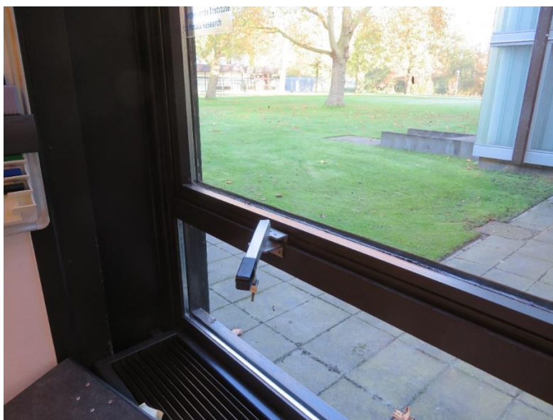
Fig 3: Raamhendels defect waardoor ramen niet goed sluiten.
